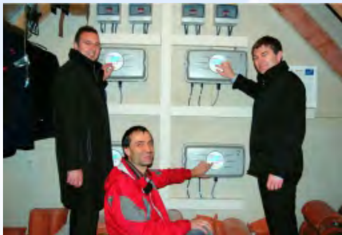
Die damaligen Vorstände Rolf Heller und Frank Müller, sowie Aufsichtsratsvorsitzender Ian Schölzel (v. l.) bei der offiziellen Inbetriebnahme der ersten PV Anlage am Aichholzhof im Dezember 2008.
